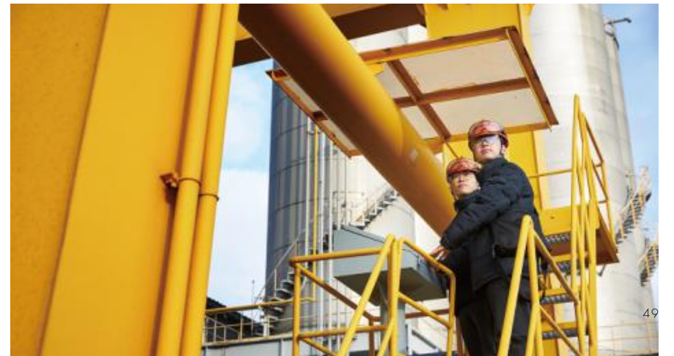
현장 고위험 설비 '안전장치 작동' 점검
