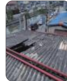
지붕재 노후화로 파손되어 떨어짐
