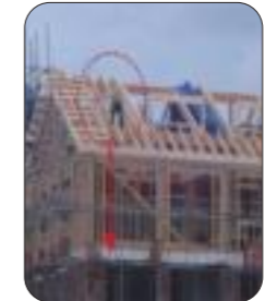
지붕 트러스, 철골 구조물 위 지붕 패널 설치 중 떨어짐
